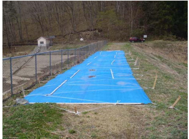
堤帯天端のクラック(中央のみ)
