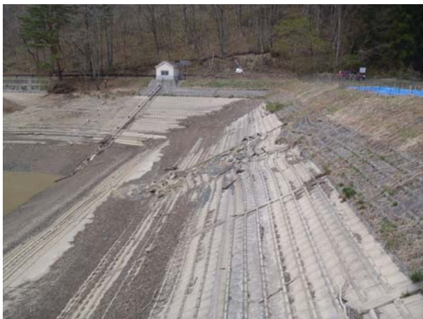
天端クラックと連続した滑り
